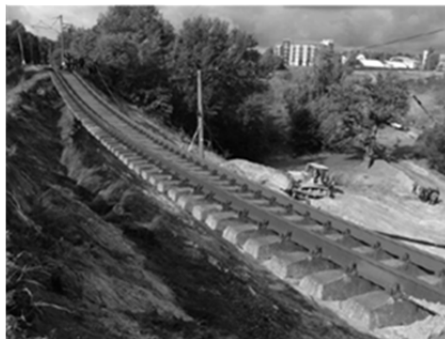
Рис. 3. Оползень насыпи под участком железнодорожного полотна у г. Светлогорска (фото И. Зарембо, ИТАР-ТАСС; предоставлено Б.А. Ассиновской, ГАО РАН)
